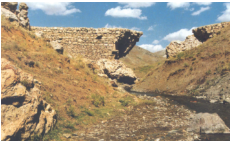
Fig. 79 Barrage de Faruk après l'effondrement de la rive gauche
