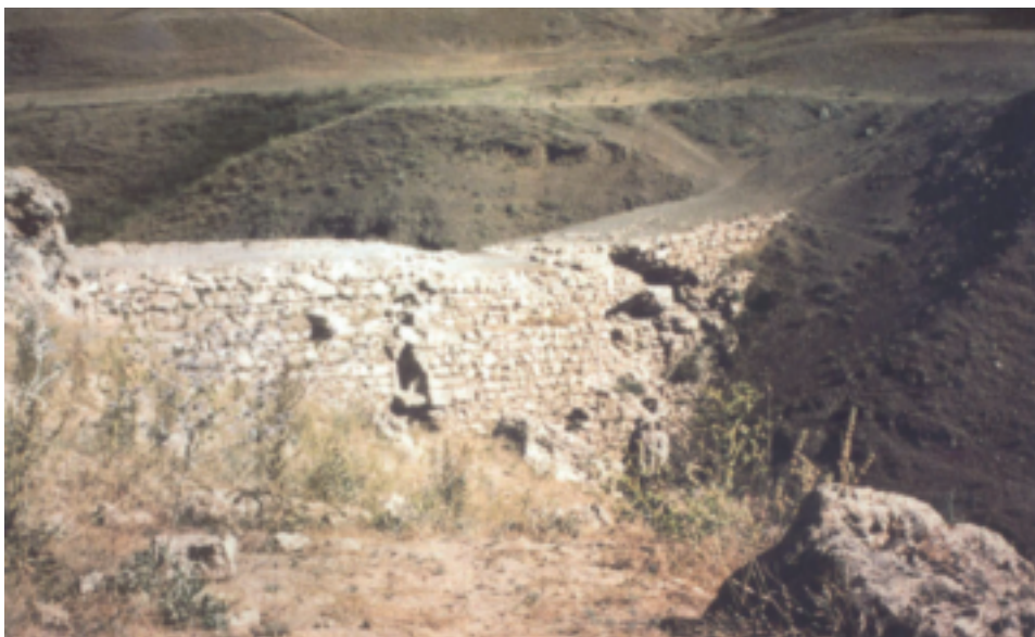
Fig. 78 Vue aval du barrage de Faruk de 12 m de haut pour 30 m de long (avec la moitié rive gauche, à la droite de la photo, effondrée en 1988) près de Van
