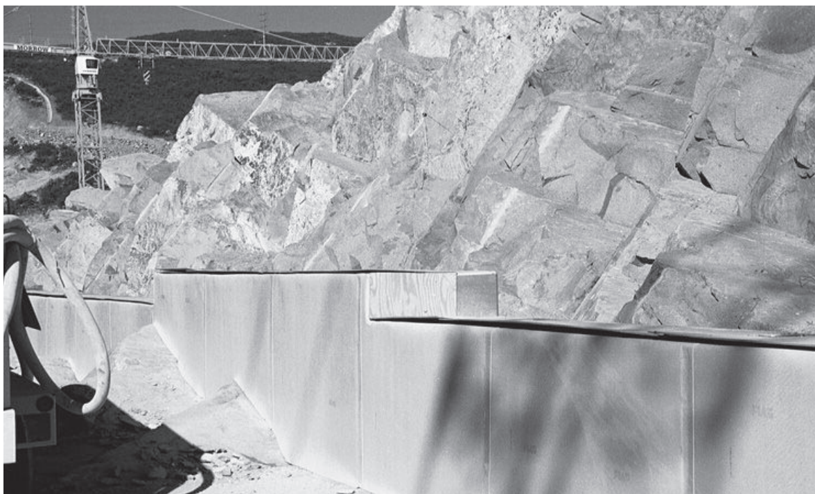
Fig. 122 Protection en bois du revêtement PVC à Olivenhain, États-Unis, 2003
